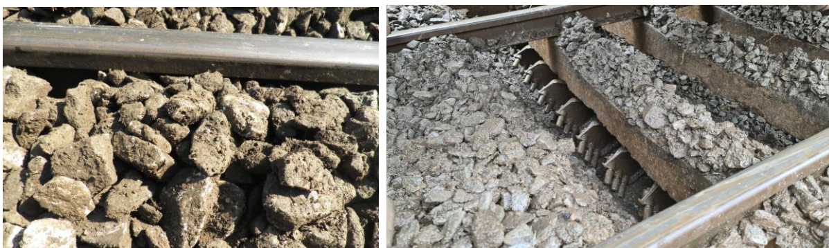
Obr. 5 – Příklad špatně vyčištěného kolejového lože automatickou strojní čističkou SČ 600 (rok výroby 1986) a nedodržení technologických postupů (kol. lože se nesmí čistit za deště).
