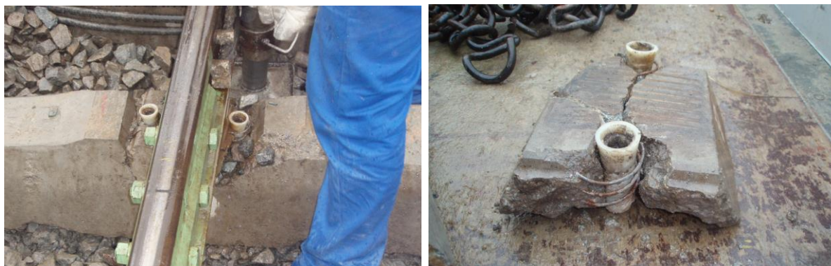
Obr. 6 – Příklad poškození pražce a hmoždinek v uzlu upevnění po použití zakázané zatáčečky (Master 35) bez nastavení utahovacího momentu.
