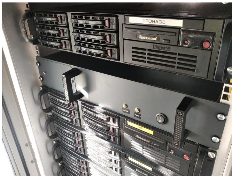
Obr. 12 – Měřicí a vyhodnocovací jednotka HLUKOS instalovaná v MVŽSv2 [zdroj: autoři]
